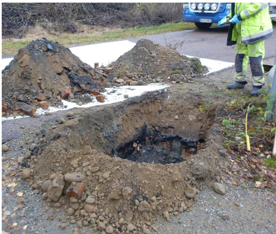
Figur 2-2. Exempel på heterogena fyllnadsmassor med inslag av tegel, tjärpapp och sot på en gasverkstomt med förorening av bl.a. PAH och cyanid. Foto: SGI.
