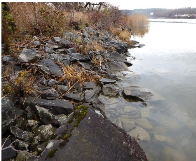
Figur 6-2 Erosionsskydd (bergkross) längs med älvstranden, foto från platsbesök 2019-11-14.
