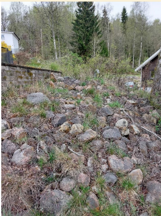
Foto 4 Uppfyllnad nedanför murad stödmur
