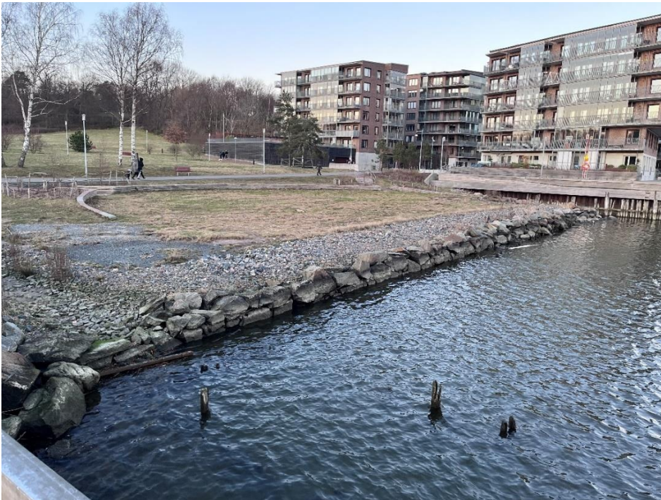
Figur 5.19: Befintligt erosionsskydd/strandskoning vid strandängen. Bild tagen i nordostlig riktning vid platsbesök av WSP, 2025-02-11.
