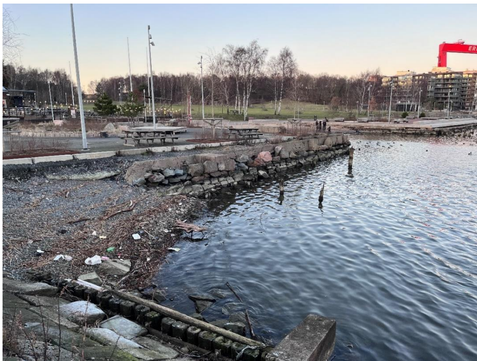
Figur 5.14: Befintligt erosionsskydd och förstärkningsåtgärd vid entrétorget. Bild tagen i nordostlig riktning vid platsbesök av WSP, 2025-02-11.
