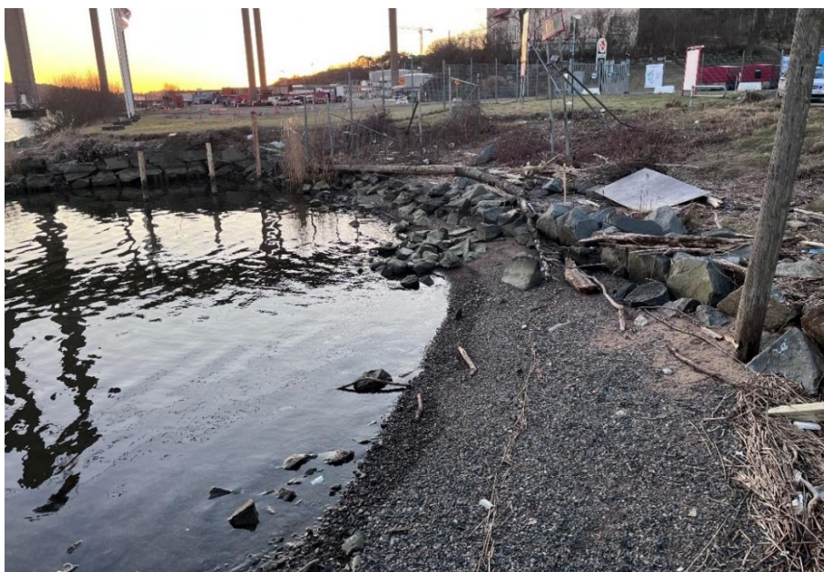
Figur 5.13: Befintligt erosionsskydd väster om det tidigare färjeläget. Bild tagen i västlig riktning vid platsbesök av WSP, 2025-02-11.
