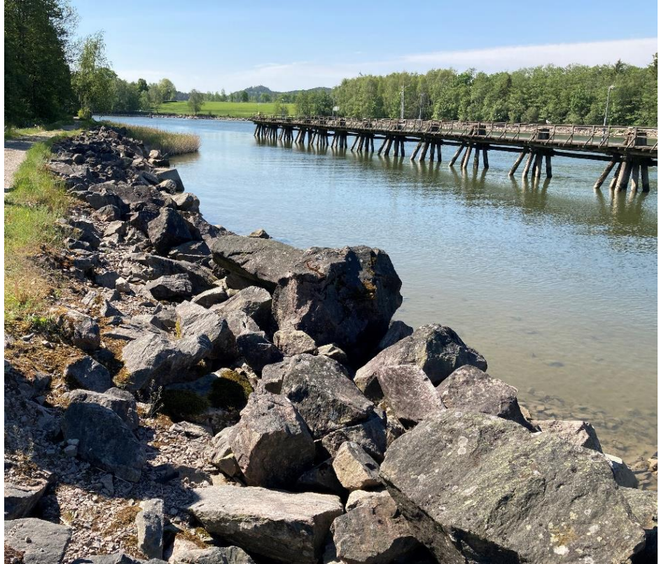
Figur 5. Erosionsskydd i södra delen av utredningsområdet, fotograferat åt söder (COWI AB, 2021).
