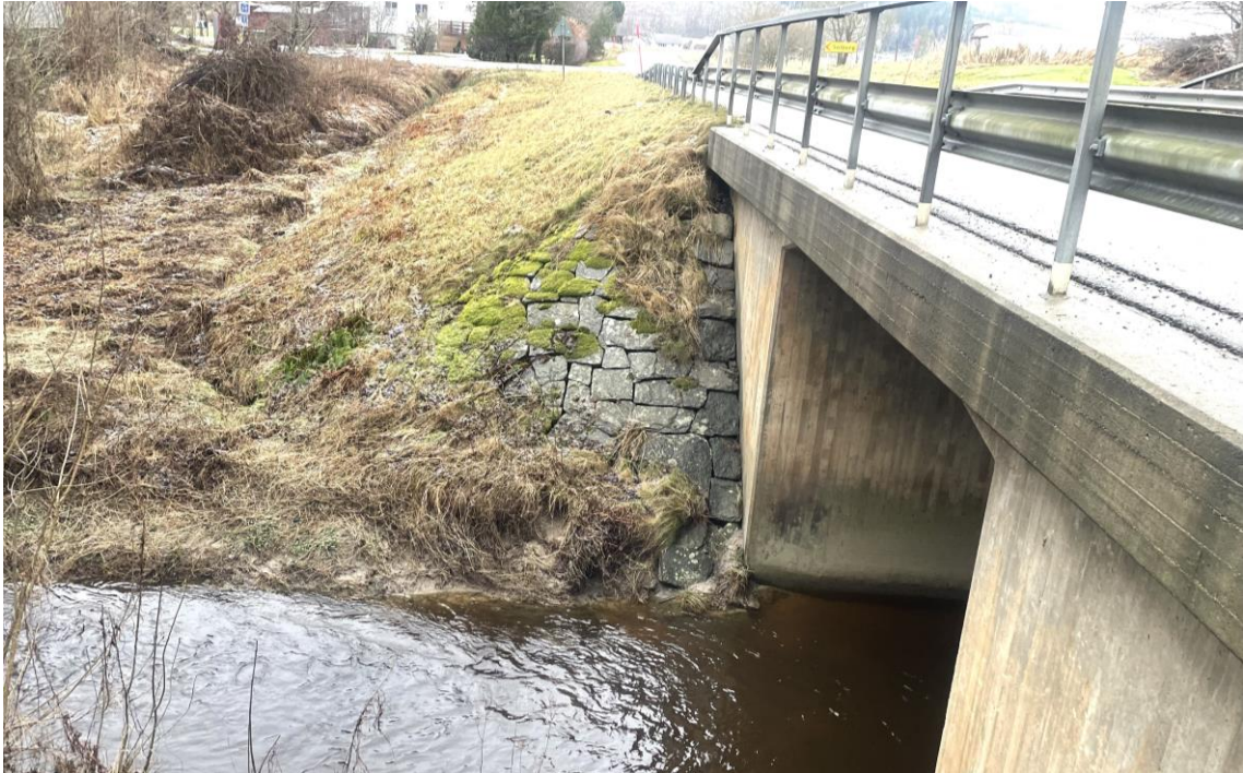
Figur 5. Glacis vid bron nordvästra sida. Delvis skadad med synlig bar jord i anslutning till ån.
