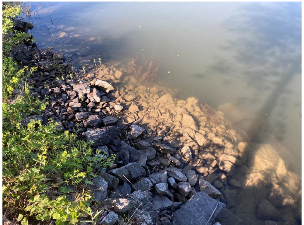
Figur 5. Erosionsskydd i område A (COWI AB, 2021).
